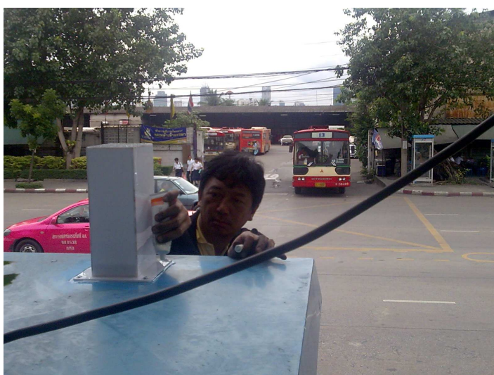
รูปที่ 6 ตัวอย่างตู้โทรศัพท์ที่ติดตั้งอุปกรณ์ B-Base
